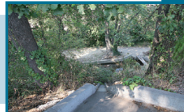
Canalisation des eaux le long du talus chemin de la Chapelle Sainte-Anne
