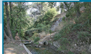
Risque de glissements de talus
